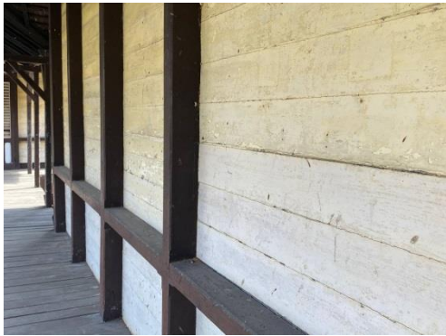
Dinding papan kayu horizontal di bagian luar bangunan terdapat kayu penyanggah dinding
