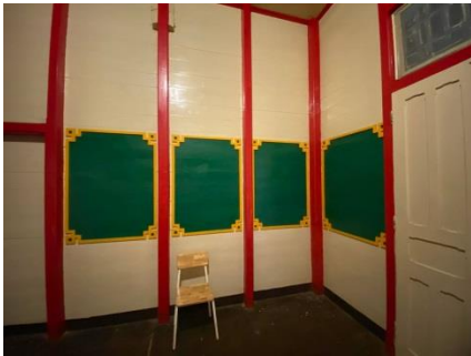
Bagian dinding samping kamar menggunakan kayu yang berbentuk vertical dan terdapat bagian yang sudah di cat dengan bentuk persegi 4
